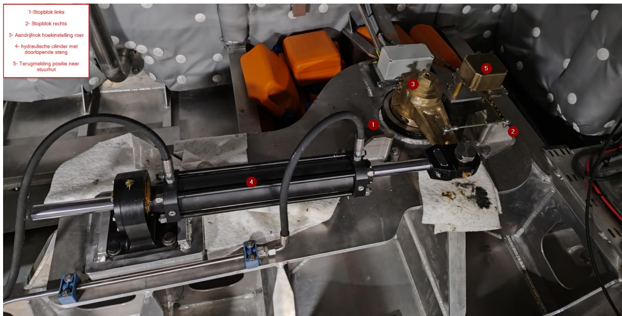
Figuur 22: cilinderopstelling roer foto 1
